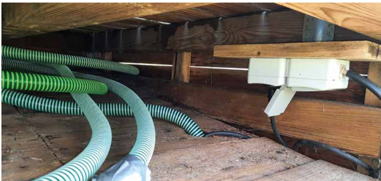
Unter "Deck" liegt der Stromanschluss für die Pumpe und die dicken Schläuche zur Bewässerung. | Foto: mg
